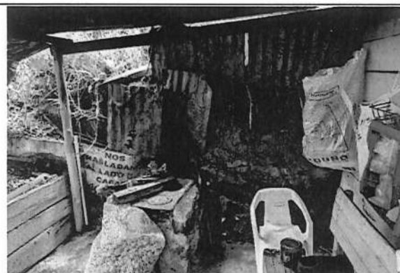
Estufa de leña modulo separado e mal estado
