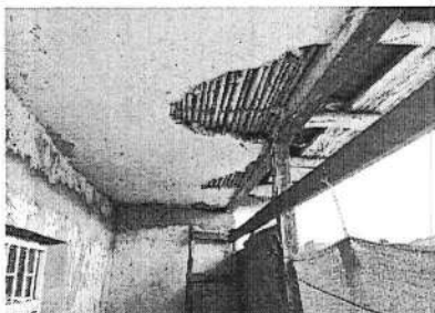
DESGASTE DE CUBIERTA Y CIELO FALSO
