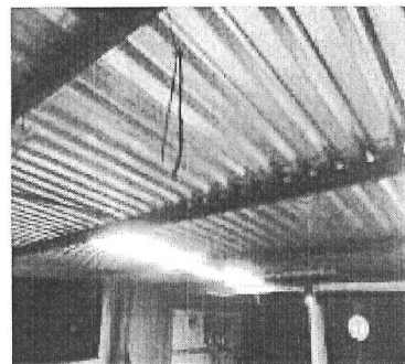
CUBIERTA CON MULTIPLES FILTRACIONES
