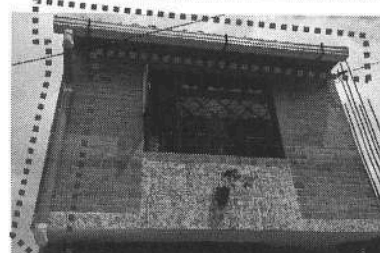
CANALETA Y BAJANTE
