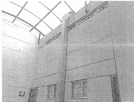
Ducto que obstruye la apertura de la ventana.
