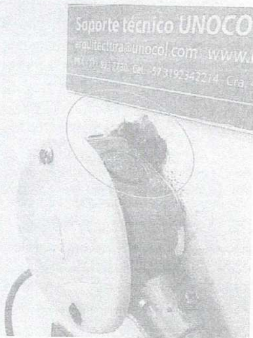
Pendiente remate en muro drywall.
