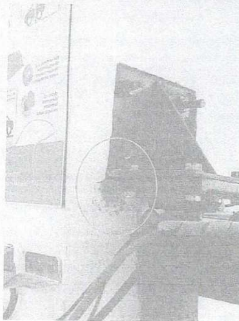
Pendiente remate en muro, bajo platina de anclaje puerta.
