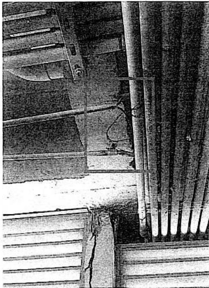
Tubería eléctrica PVC. No hay una conexión adecuada entre la tubería.
