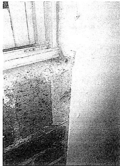
Rastro de humedad.
