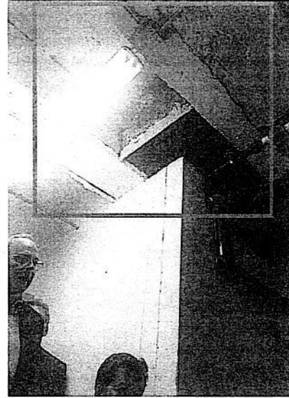
Malos acabados en placa de entrepiso por desencofrado.
