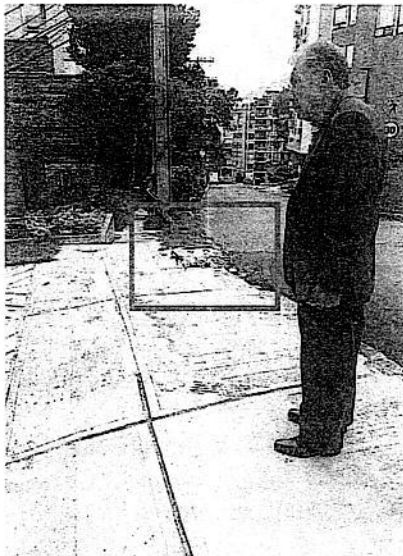
Anden y caja desportillados.
