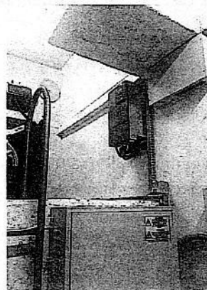
Cuarto de máquinas.
