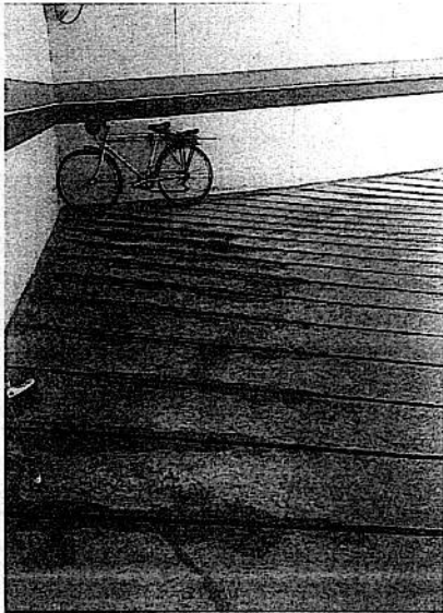
Piso húmedo de la rampa.
