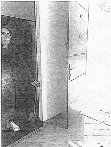
Muro por donde ingresa la acometida del gas.
