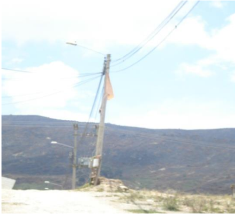
El tendido eléctrico
