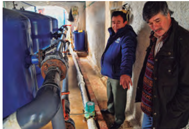
Actual sistema de potabilización.
