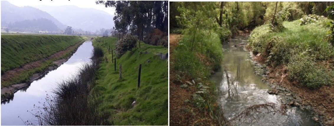
Figura 104 Detalle del cauce actual del Canal Guaymaral, sector medio (izq.) y sector bajo (der.)
