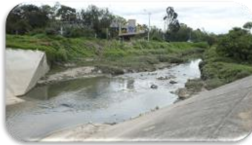
Fotografía 10: Canal de Torca con problemas de sedimentación y residuos sólidos
