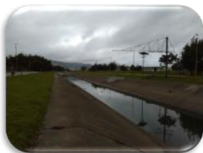
Foto 1. Canal Torca Costado Oriental Autonorte Fuente: UT Corredor Ecológico Humedales de Torca y Guaymaral, 2016
