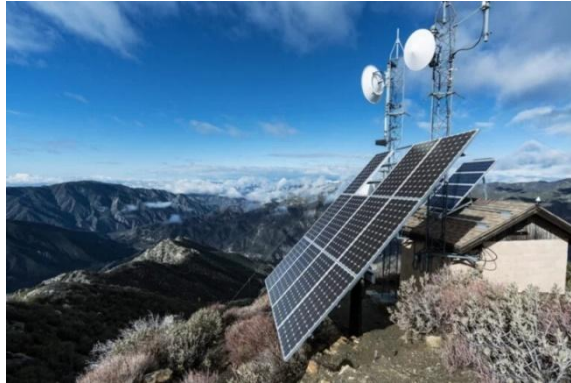
Figura 1.48 – Uso de Paneles Solares en Estaciones Radioeléctricas de Telecomunicaciones
