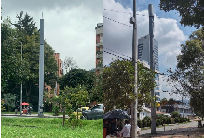
Figura 1.17 Estaciones radioeléctricas tipo mástil, instaladas en el espacio público.
