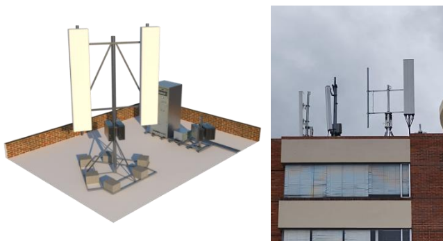
Figura 1.10. Estructura de Soporte – Mástiles sobre bienes de propiedad privada
